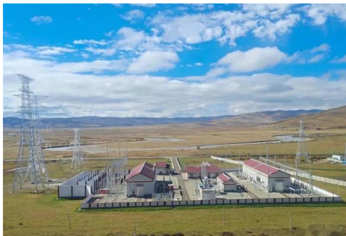
图 2.1-1 已建成红原 220kV 变电站实景
